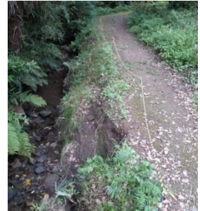
写真 4 園路近くまで浸食あり
